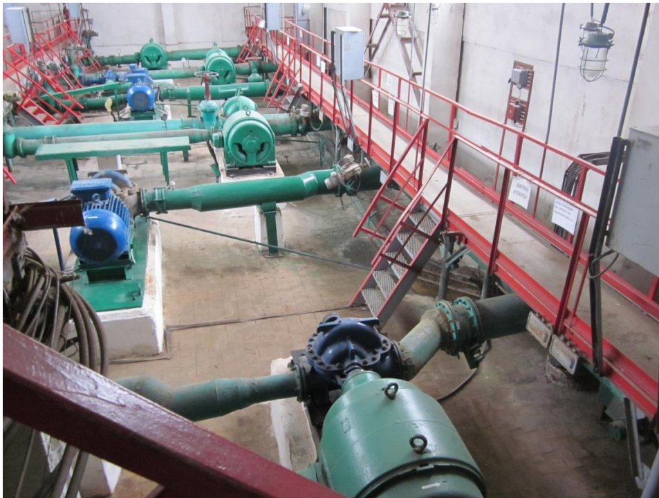
Общий вид машинного зала станции 2-го подъема.
